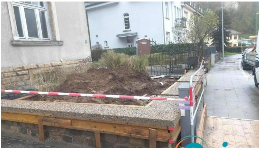
Agnes constructions succ sa beton
