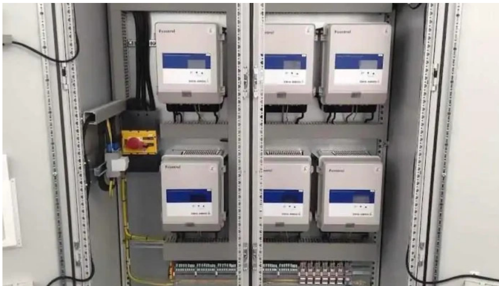
Cablux sa sassenheim
