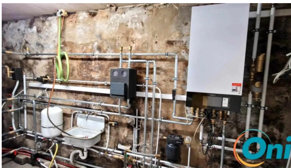
Kayser chauffage et sanitaire neueste
