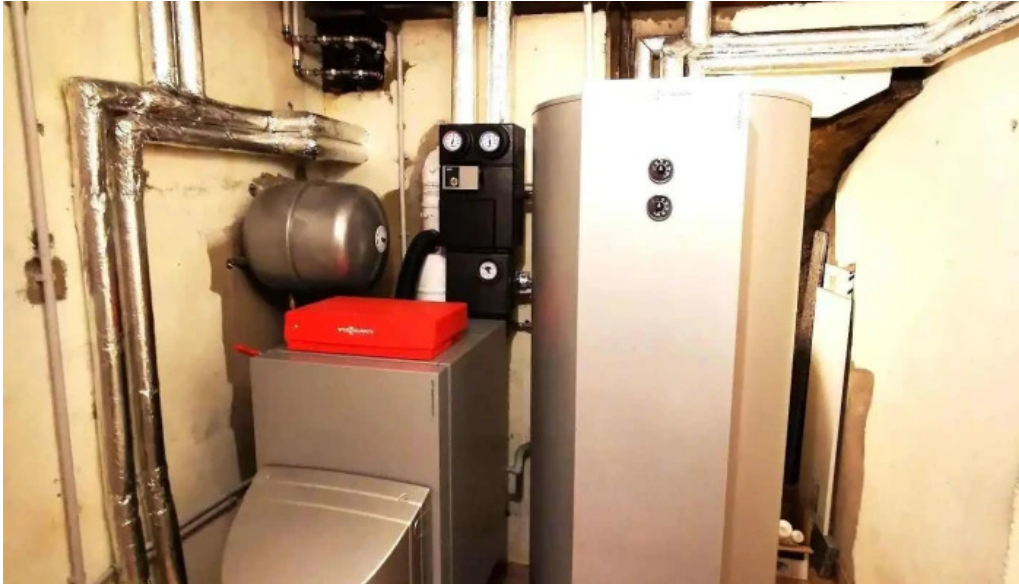
Kayser chauffage et sanitaire innenansichten
