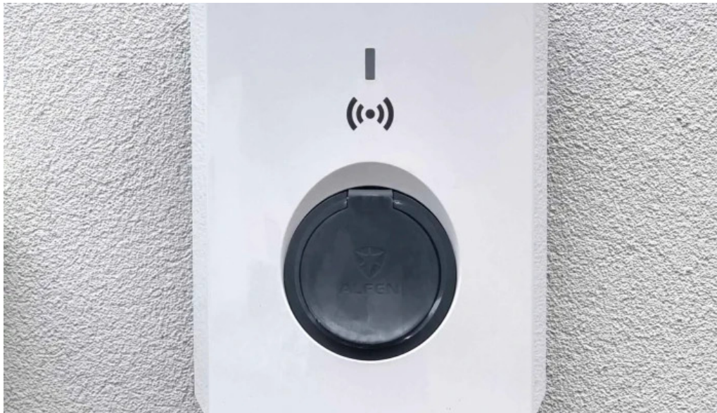
Carpower ladestation helperknapp
